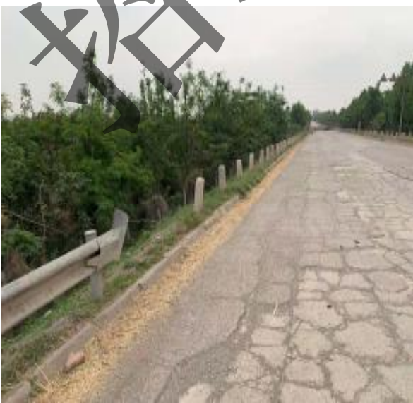
顺接桥梁护栏损坏
