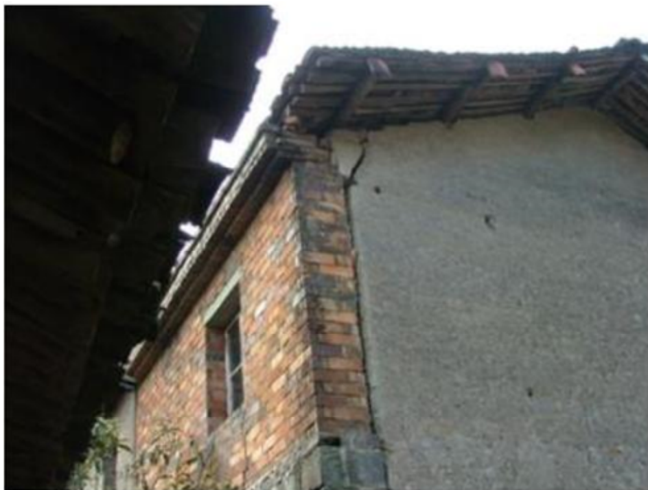
图 1.3- 49 砖墙与土墙间通缝拉脱
