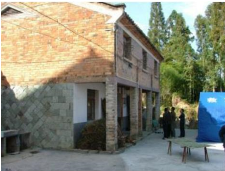
图 1.3- 47 石柱、砖墙混杂的房屋
