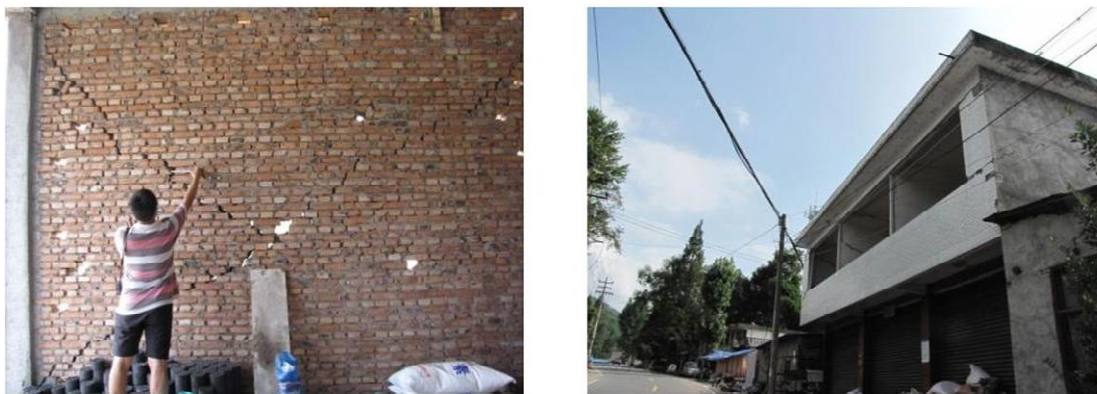
图 1.3- 28 地震中底框房屋的破坏现象,因扭转而加重震害
