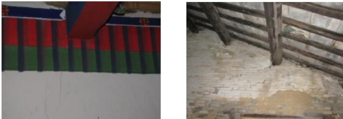
图 1.3- 62 檩条下局部受压裂缝
