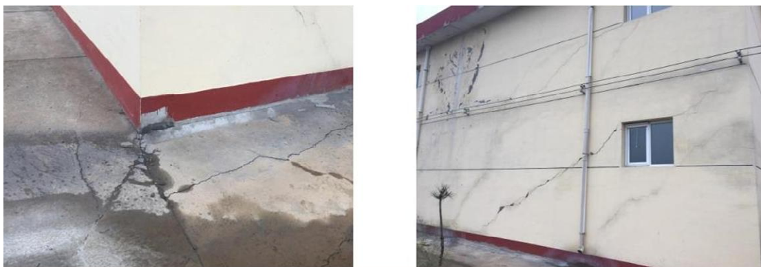
图 1.3- 66 地基基础不均匀沉降引起的散水开裂、墙体裂缝
