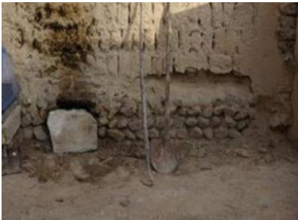
图 1.3- 68 生土墙体墙根部剥蚀削弱
