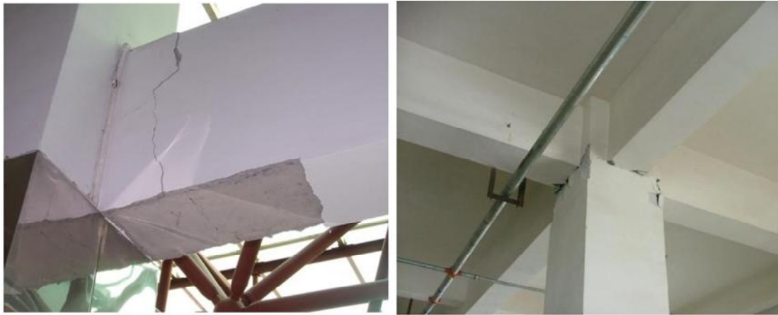
图 1.3- 12 混凝土结构构件裂缝
