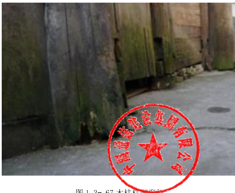
图 1.3- 67 木柱柱脚腐朽
